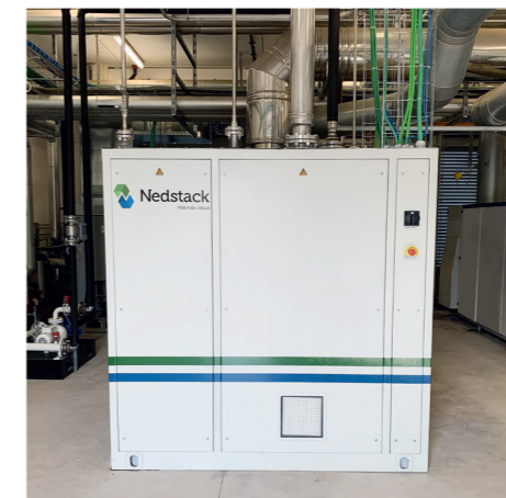
Kast met een 100 kW (MT-FCPI-100) brandstofcelstelsel van Nedstack geïnstalleerd bij een maritieme klant
